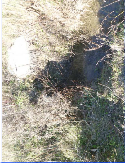
Tratto a cielo aperto a valle del \phi 1000 (vista da valle verso monte)
